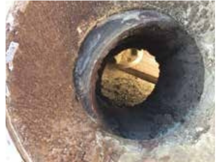
Efter två månader i drift visade en konkurrens ventils tecken på uppströms kraftig mediauppbyggnad - vilket orsakade frekventa läckor och låsningar.
